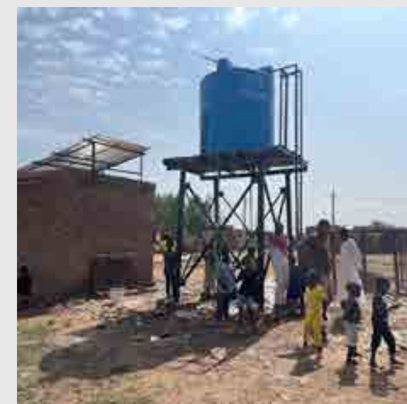
© AICS Luglio 2023. Mayo - Stato di Khartoum Installazione di pannelli solari e serbatoi d'acqua potabile.
